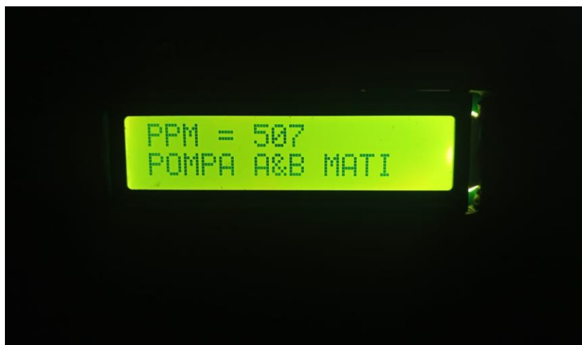
Gambar 39. pengujian pertama menggunakan EC sensor
