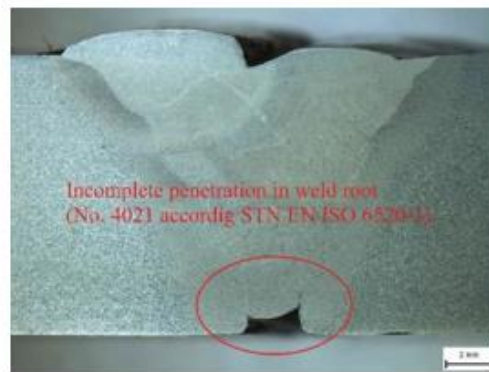
Gambar 10. Incomplete penetration muncul sebagai cacat ketika logam las tidak sepenuhnya menyatu dengan logam dasar di akar las, sehingga mengakibatkan diskontinuitas [50].
